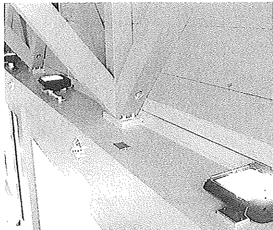
天井面にあたるよう取り付けられた間接照明器具
